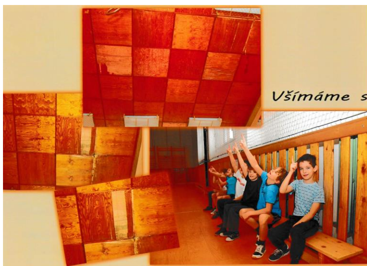
Fotografie č. 1 : Poškozený podhled tělocvičny.
